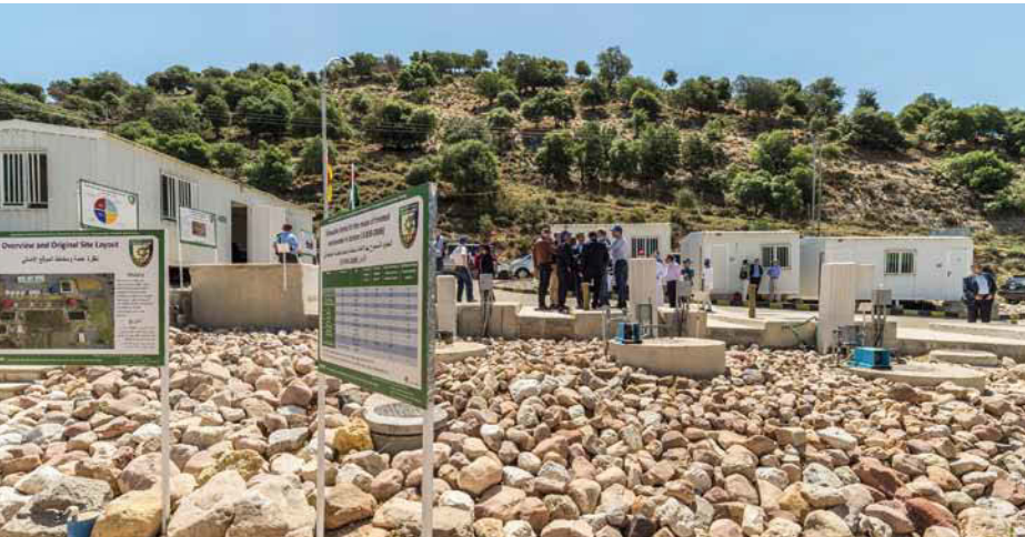
Pilotanlage In Fuheis (Jordanien) werden seit 2010 unterschiedliche dezentrale Technologien zur Abwasserreinigung getestet. Bilder: André Künzelmann/UFZ
