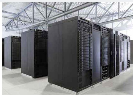
Das erste Modul von JUWELS in der Rechnerhalle des JSC Bild: Forschungszentrum Jülich/R.-U. Limbach
