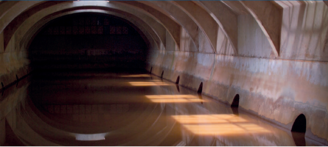
Rückhaltebecken eines Wasserwerks. Bild: André Künzelmann, UFZ
